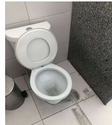
VASOS SANITARIOS A SEREM SUBSTITUIDOS
